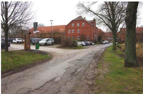
Insbesondere der nördliche Abschnitt der Bergstraße in Ockensen weist erhebliche Schäden auf. Die Zufahrt zum Parkplatz der Mosterei sowie zum Friedhof sind zu berücksichtigen.
