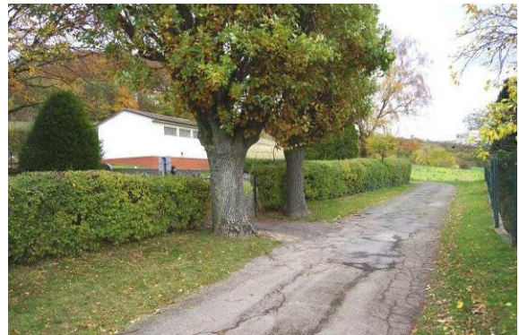
In Levedagsen erschließt die Straße Am Wellenbache u.a. den örtlichen Friedhof. Neben dem Bedarf der Sanierung sollte der ruhende Verkehr reglementiert werden.
